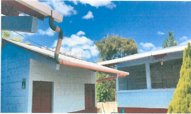
Foto 1: Reparación de canales estan en mal estado
